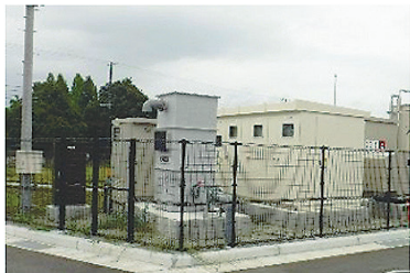
非常用発電機の整備による無停電化対策
