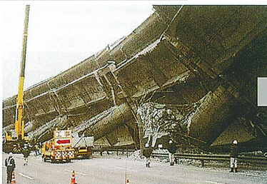
兵庫県南部地震における被災状況
