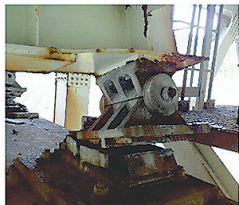
熊本地震における橋梁の支承・主桁の損傷(大分自動車道・並柳橋)
